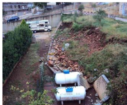
crollo per innalzamento del livello dell'acqua a tergo
